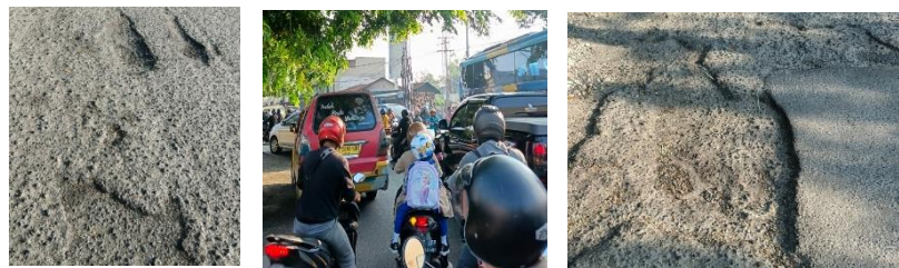
Gambar 1 Kerusakan Jalan di Jalan Menteng VII Mengakibatkan Kemacetan
