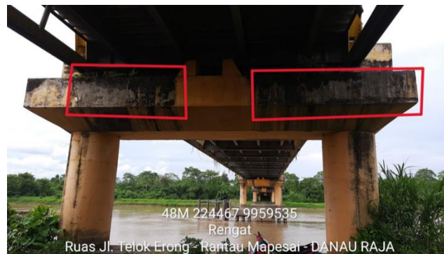
Gambar 7. Honeycomb pada gelagar jembatan
